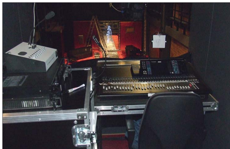
System elektroakustyczny bazuje na cyfrowej konsoli Yamaha LS9, zainstalowanej w kabinie akustyka, aczkolwiek równie dobrze może być ona obsługiwana w kilku lokalizacjach znajdujących się na widowni.
