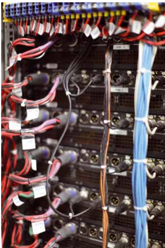
Przesyłanie kilku kilowatów mocy na duże odległości wymaga zastosowania kabli głośnikowych o znacznych przekrojach.
